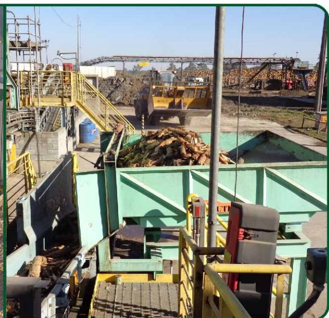
Wood Wastes Chipping Line Table / Linha de Picagem de Resíduos
